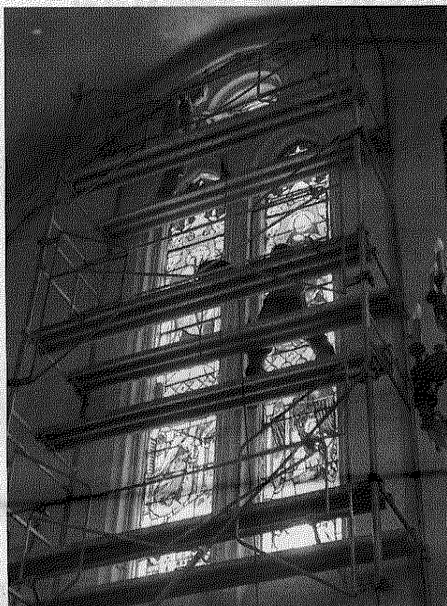
Démontage délicat des vitraux abîmés sur un échafaudage de 10 mètres de haut.
